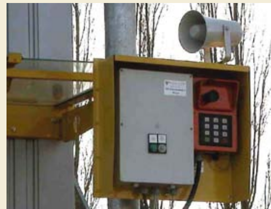
Transponder-Kartenleser mit Sprechanlage und Nebengeräuschunterdrückung
